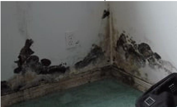
Maison envahie par la moisissure dans la Première Nation de Kashechewan après les importantes inondations de 2014 (CBC News, 2015).
